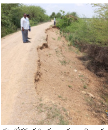
కట్ట కోతకు గురికాకుండా చూడాలని ఆయా గ్రామాల రైతులు, ప్రజలు కోరుతున్నారు.
