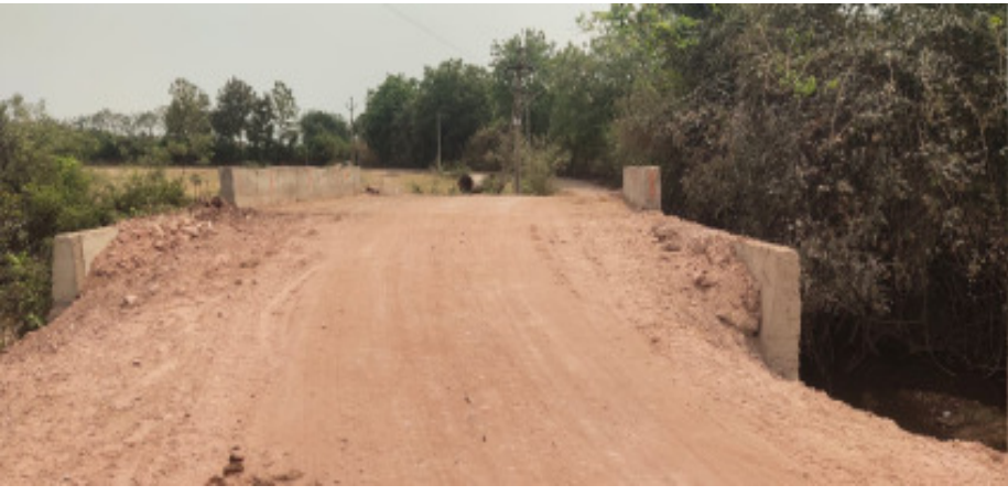
అసంపూర్తిగా కల్వర్లు, అప్రోచ్ రోడ్డు పనులు...
